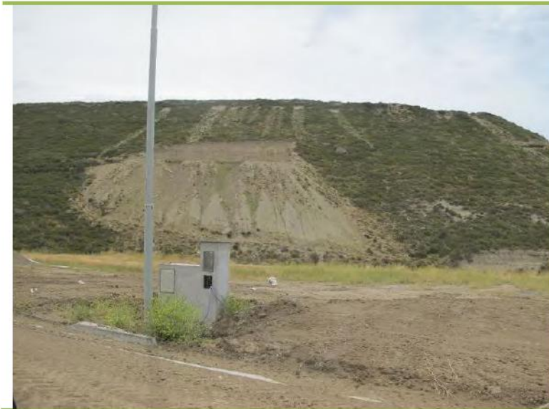
Imagen 38: En la ladera norte se observa talud de locación de pozo petrolero. En la zona superior se observan signos de erosión hídrica producto del desbroce y movimiento de suelos en la zona más alta.
