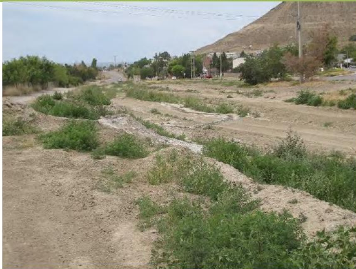
Imagen 33: Vista de la Calle F.L. Beltrán. en zona donde se han iniciado maniobras de relleno del canal generado como consecuencia de la tormenta del año 2017. Vista en dirección Este. Ubicación: 45°50'22.47"S 67°29'54.26"O
