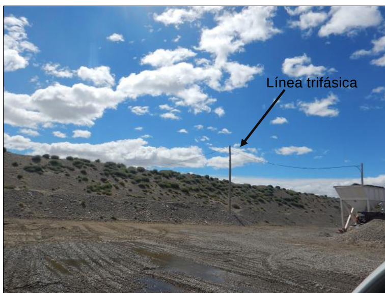
Sector de la cantera donde llega la energía eléctrica para el funcionamiento del alimentador
