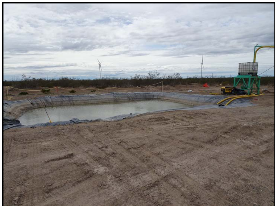
FOTO N° 26: Vista de la cisterna para acopio de agua de reuso
