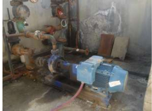
Foto 8 - Signos de corrosión y pérdida de aceite en bomba
