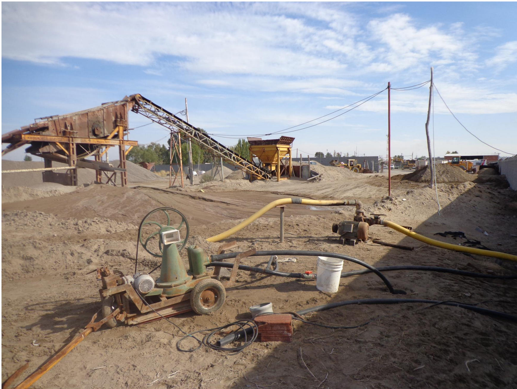
PLANTA DE TRELEW DONDE SE OBSERVA EL POZO, LA ZARANDA Y EL EQUIPO DE BOMBEO
