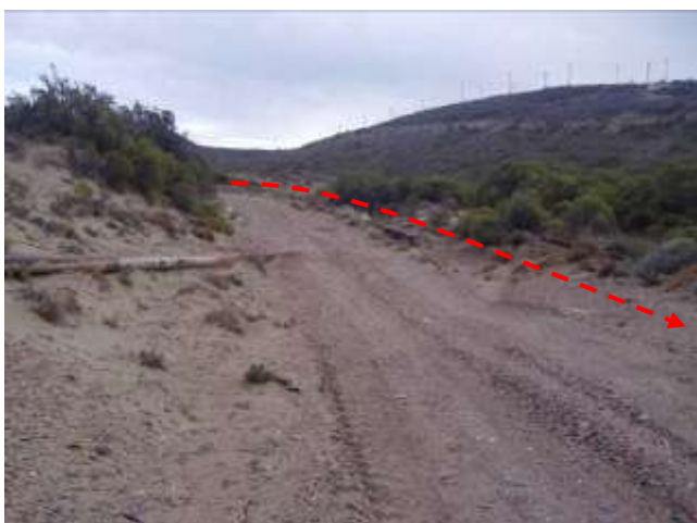
Foto III.B-44. Emplazamiento del oleoducto por picada, interferencia con ducto. Foto en dirección Oeste.
