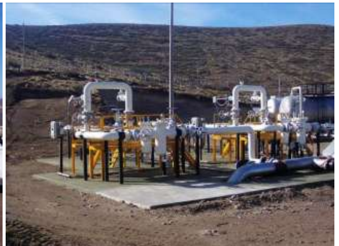
Foto III.B-36. Colector de entrada de la Planta Deshidratadora Manantiales Behr. Foto en dirección SE.
