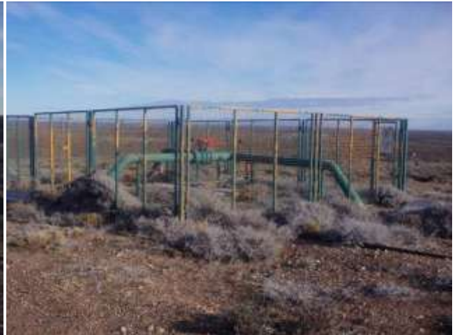
Foto III.B-10. Cuadro de maniobras del acueducto. Foto en dirección NO.
