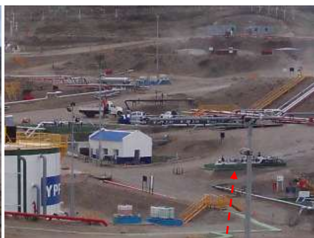
Foto III.B-61. Fin del oleoducto en un colector de la Planta Deshidratadora MB. Foto en dirección Norte.
