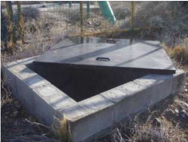
Foto III.B-11. Cámara de inspección ubicada al lado del cuadro de maniobras del acueducto, contemplado en la foto anterior. Se encuentra a 118 m al NE de la Ruta Provincial N° 37.
