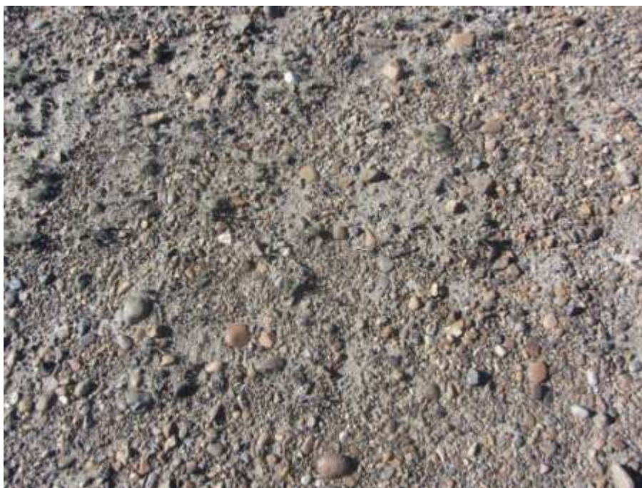
Imagen 15. Vista pavimento de erosión
