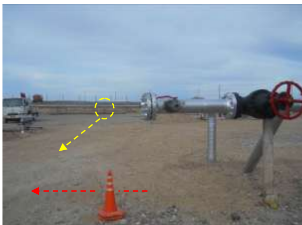
Foto III.B-3. Inicio de oleoducto (rojo) en válvula de conexión. Detrás se observa tetón del futuro gasoducto (amarillo). Foto en dirección Sur.
