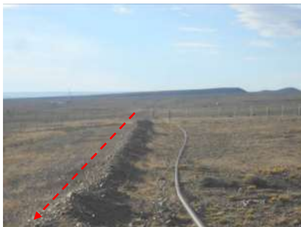
Foto III.B-45. Emplazamiento de oleoducto por picada. Se observa alambrado de fondo. Foto en dirección Norte.
