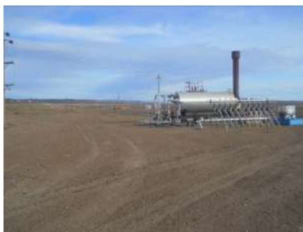
Foto III.B-34. Colector auxiliar N° 3: 90 m al Norte del área del proyecto. Foto en dirección SO.
