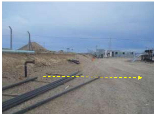
Foto III.B-2. Se observa inicio del gasoducto (amarillo) desde tetón donde conectará. Detrás colector de destino de la producción de los pozos de la zona. Foto en dirección Oeste.
